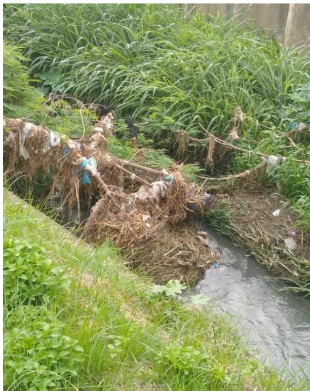
Figura 9: terra e vegetação bloqueando a passagem da água
