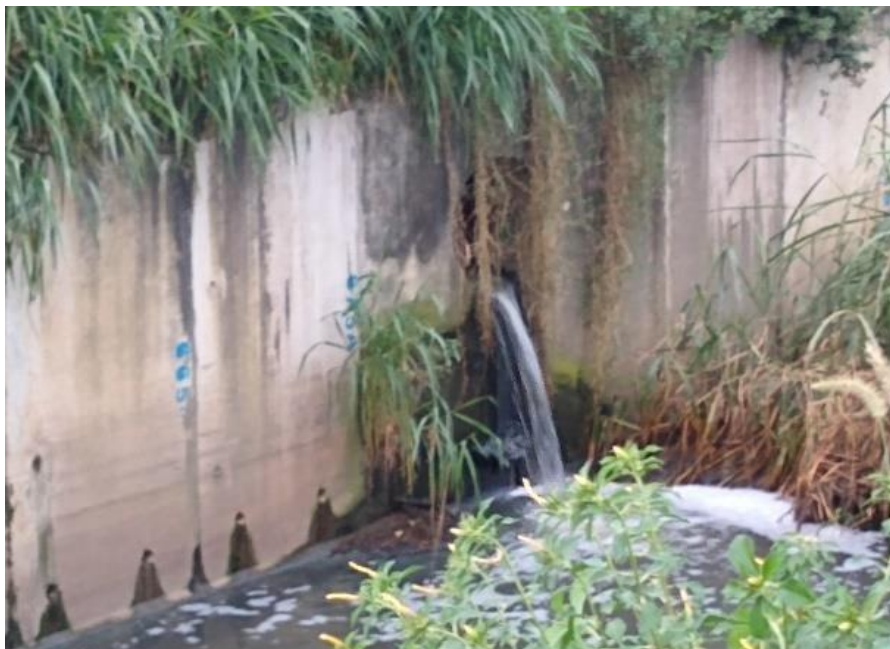
Figura 14: saída de esgoto Fonte: arquivo de pesquisa
