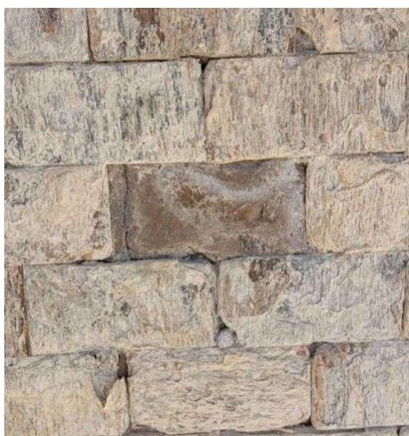
Figura 20: Desplacamento do revestimento de fachada Fonte: Acervo da autora, 2023
