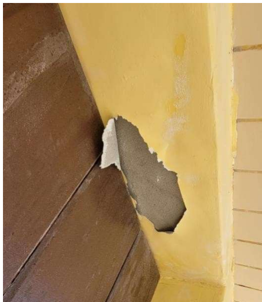
Figura 22: Desprendimento de camada de tinta Fonte: Acervo da autora, 2023
