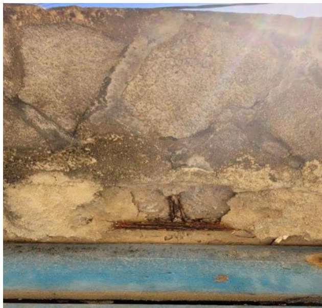
Figura 9: Armadura exposta e oxidada devido a agentes externos e deslocamento do concreto Fonte: Acervo da autora, 2023
