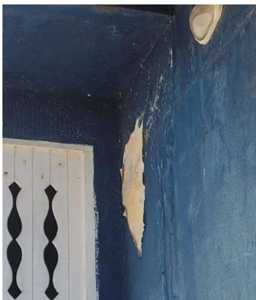
Figura 21: Desprendimento de camada de tinta Fonte: Acervo da autora, 2023
