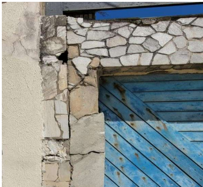
Figura 19: Desplacamento do revestimento de fachada Fonte: Acervo da autora, 2023
