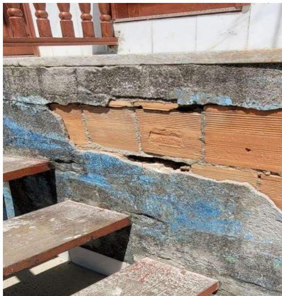
Figura 18: Desprendimento de camada componente da parede Fonte: Acervo da autora, 2023
