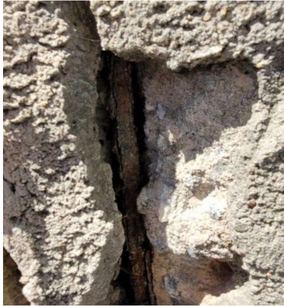
Figura 7: Rachadura em estrutura de concreto armado e oxidação em armadura Fonte: Acervo da autora, 2023
