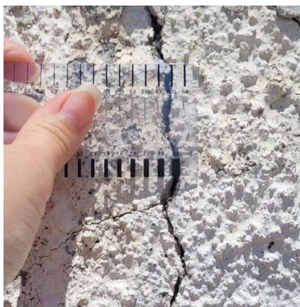
Figura 10: Rachadura de 3,0 mm de espessura medida com auxílio de um fissurômetro Fonte: Acervo da autora, 2023
