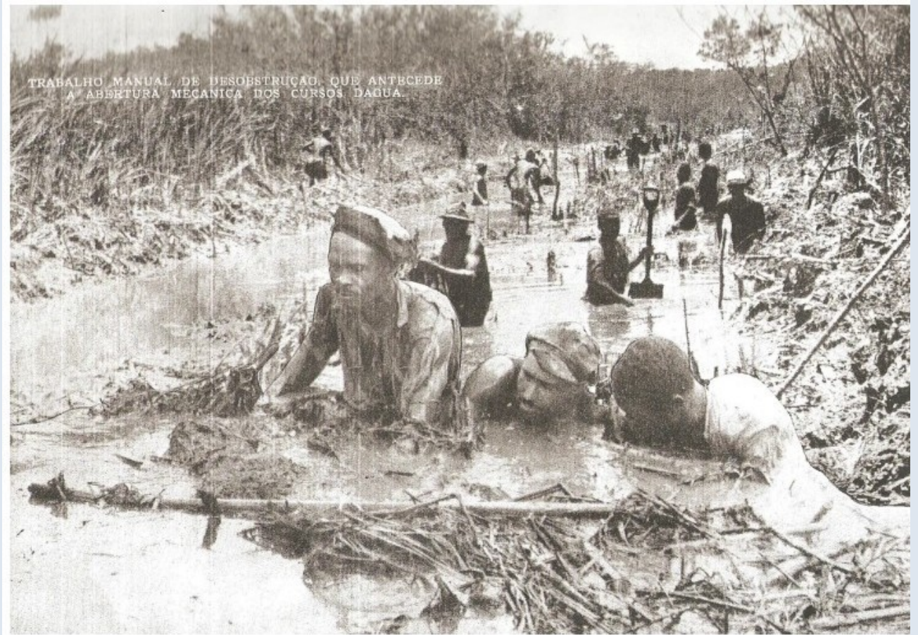
Figura 10 – Ações antrópicas mostrando o trabalho manual de desobstrução dos cursos d'água, feita posteriormente por máquinas, de forma mecânica.
