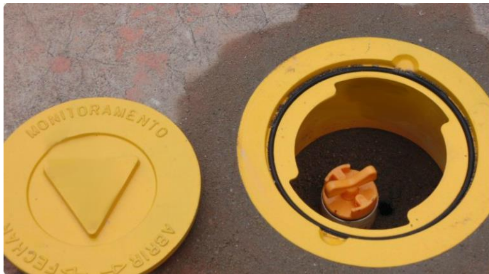
Figura 9 – Visão de um poço de monitoramento.
