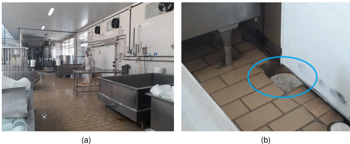
Figura 11 – Sala de manipulação após procedimentos de higienização (a) e canalização da água residual do processo de higienização (b).
