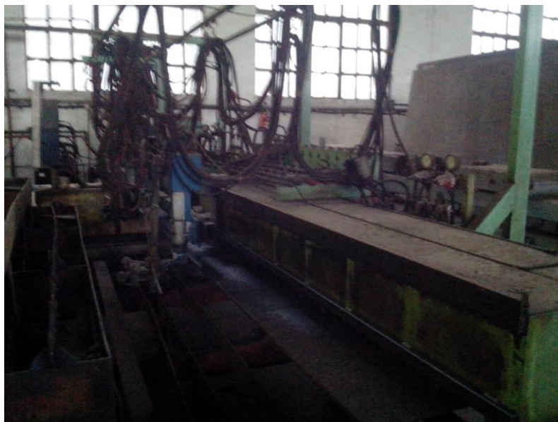
Figura 7 - Máquina de Corte e Plasma e Oxicorte, parada por falta de Manutenção
