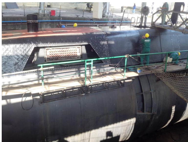
Figura 6 - Operadores trabalhando sem a ferramenta adequada
